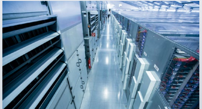
Effiziente Klimatisierungstechnik im Datacenter-Park von Hetzner in Nürnberg.
